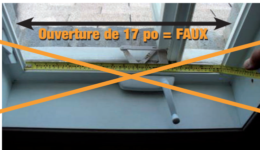
Méthode de mesurage INADÉQUATE
